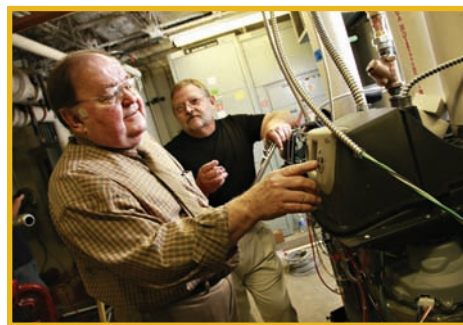
Les employés de notre usine de Georgetown (Kentucky) se sont associés avec le Palais de justice de Scott County pour déterminer les possibilités d'économiser l'énergie et de mettre en œuvre des moyens d'en réduire la consommation.
